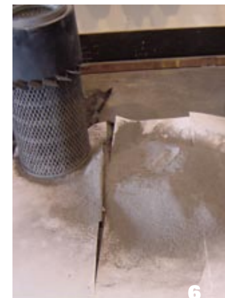
5. In een aluminiumsmelterij in Dubai werden luchtfilters op het contragewicht gemonteerd om de levensduur van de motoren te verlengen en problemen met het onderhoud te vermijden. 6. Alumina poeder veroorzaakt problemen omdat het zo een licht en fijn materiaal is.
